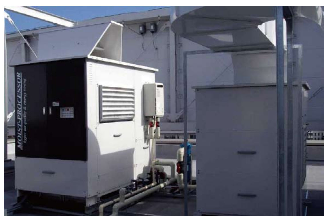
MP-3500 タイプ設置事例
