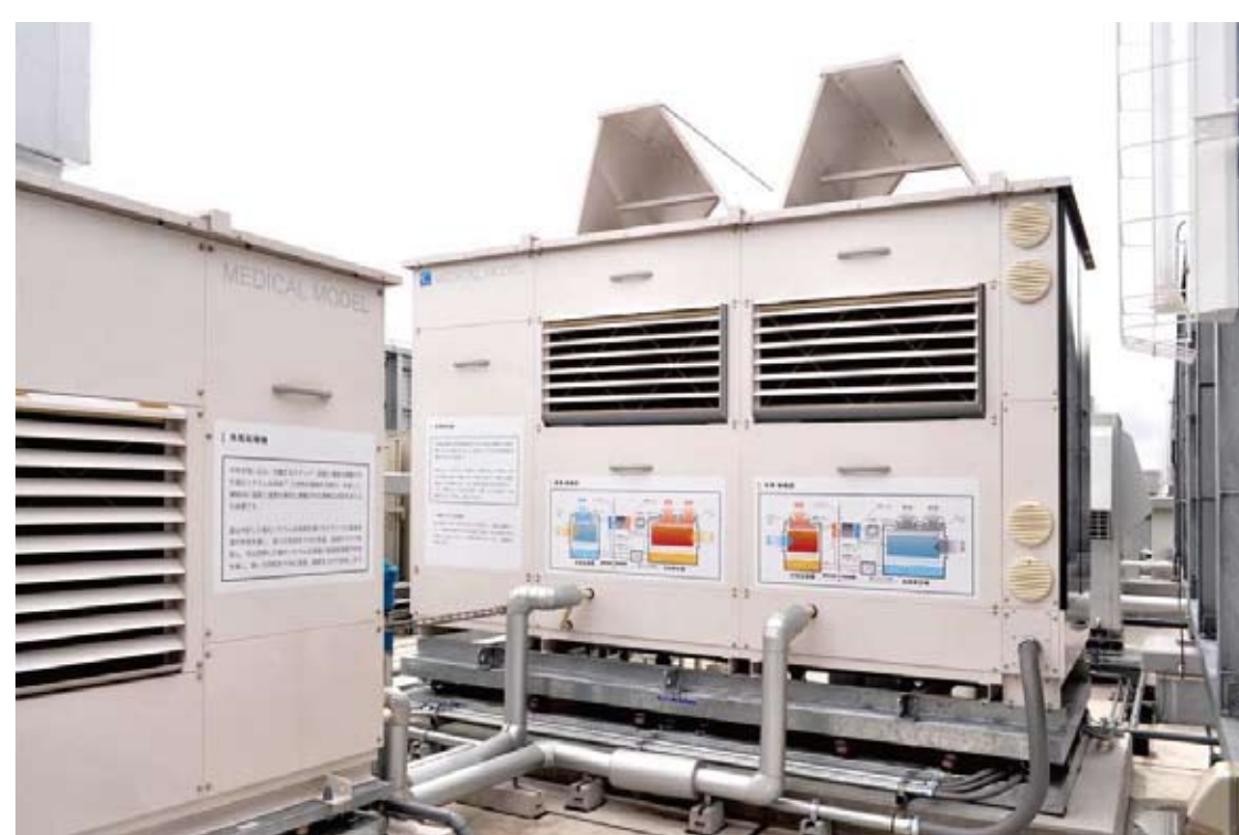
MP-6500 タイプ設置事例
