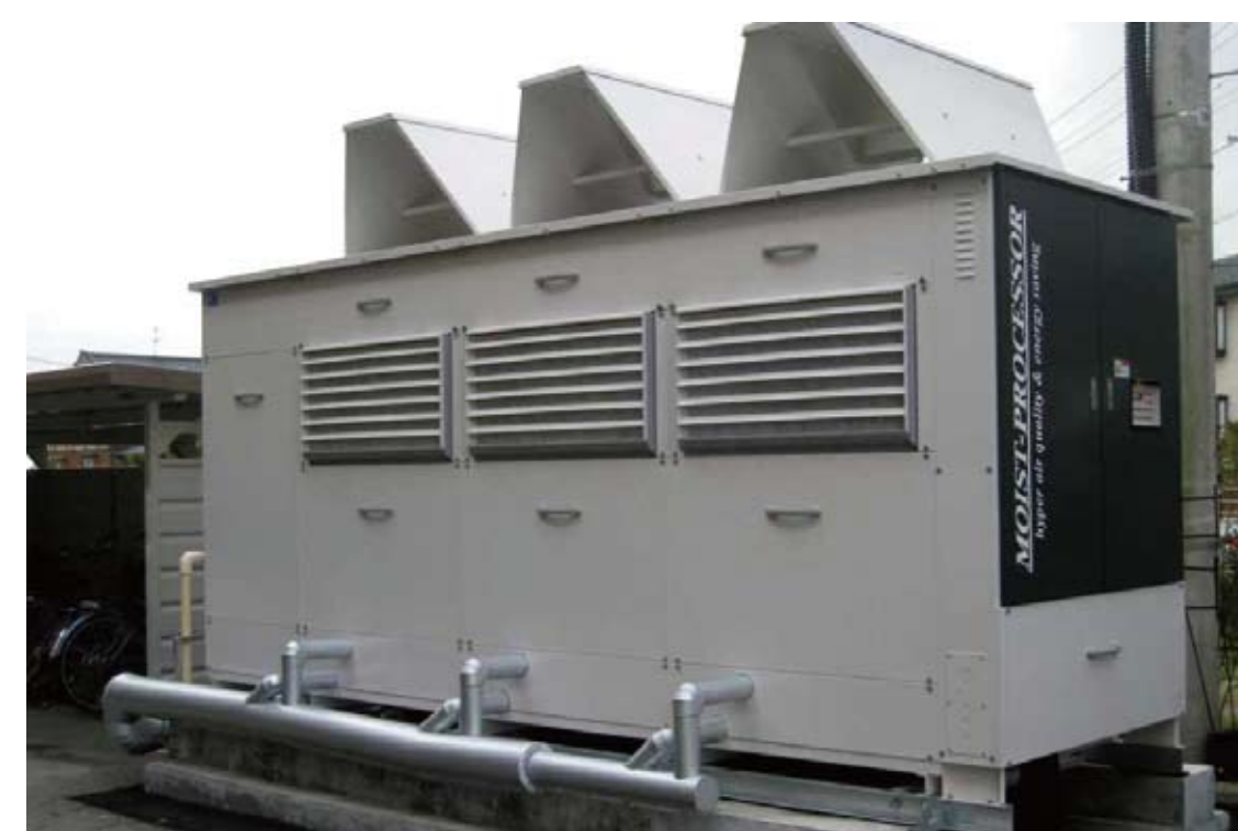
MP-9500 タイプ設置事例
